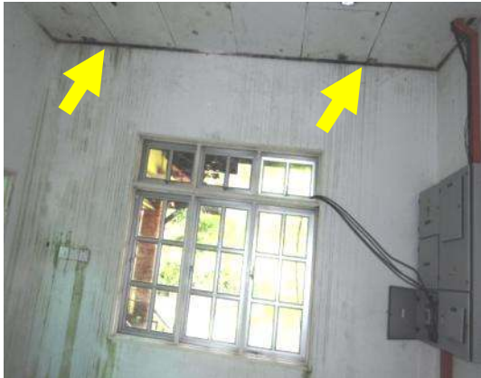
Gambar 2.16 Aliran Air Hujan Merosakkan Siling Dan Dinding Bangunan Utama
