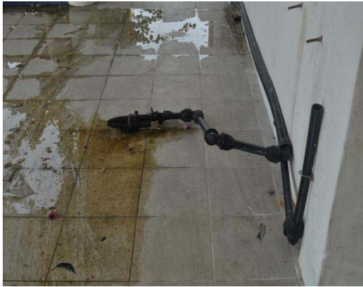
Gambar 3.10 Keadaan Lantai Tandas Yang Kotor
