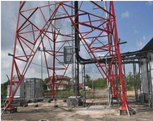
Gambar 4.1 Tapak Menara- Kampung Wang Ulu Celcom - 5Way
