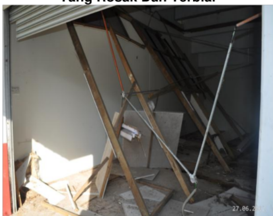
Gambar 3.6 Lot Gerai Jualan Di Stadium Utama Yang Rosak Dan Terbiar
