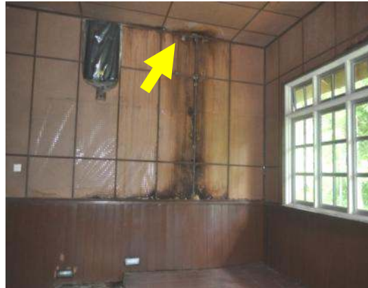
Gambar 2.17 Aliran Air Hujan Merosakkan Siling Dan Dinding Bangunan Utama
