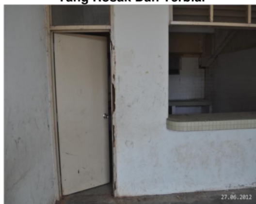
Gambar 3.7 Lot Gerai Jualan Di Stadium Utama Yang Rosak Dan Terbiar
